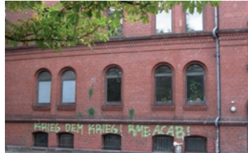
Sachbeschädigung an der Fassade der Polizeidienststelle in der Bremer Neustadt am 1. September 2025
