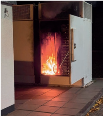
Brandanschlag auf einen Schaltschrank des Unternehmens Tesla am 17. November 2025
